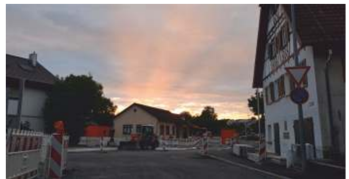
So schön kann eine Baustelle sein! Sonnenstrahlen über der Ortsdurchfahrt Cappel Bild: P. Reiter
